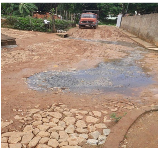
Figura 1: Registro de vazamento da rede de esgoto correndo a céu aberto.
