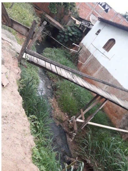
Figura 2: Despejo incorreto do esgoto doméstico.
