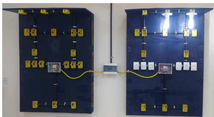
Figura 2. Painéis de instalações elétricas.
