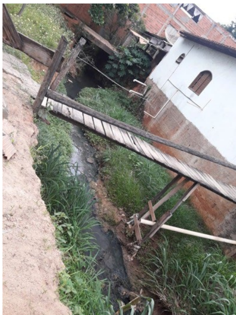
Figura 2: Despejo incorreto do esgoto doméstico.
