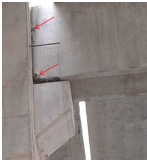
Figura 2 – Junta inexistente em ligação entre viga e pilar
