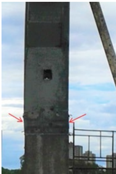
Figura 3 – Desalinhamento da ligação entre pilares
