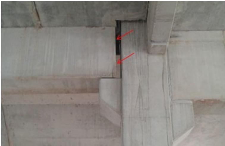
Figura 1 – Junta excessiva em ligação entre viga e pilar
