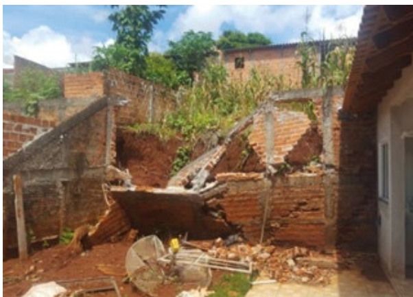
Figura 1. Muro sem contenção
