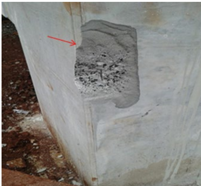
Figura 5 – Avaria no concreto com armadura exposta em pilar
