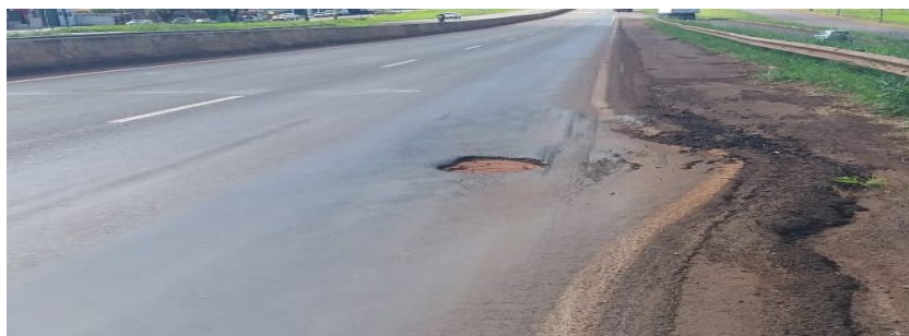
Figura 12 – Escorregamento seguido de fendas junto a PR 323.
