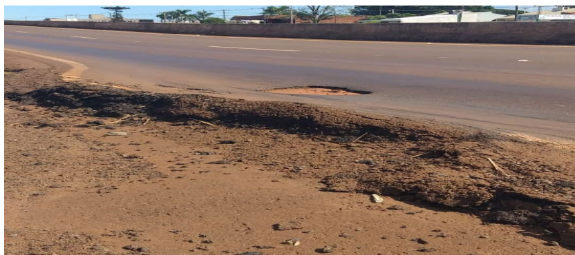
Figura 13 – Acúmulo de massa asfáltica na patologia de escorregamento.
