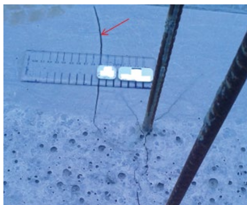
Figura 4 – Fissuras e trincas em viga de abertura de até 1,3 mm
