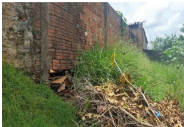
Figura 5. Falta de drenagem
