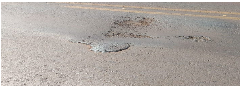
Figura 14 – Patologia de ondulação junto a outras patologias.
