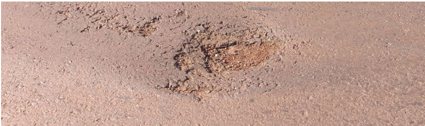
Figura 10 – Presença de panelas pelas extensões rodoviárias.
