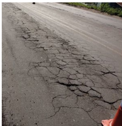
Figura 3 – Pavimento antes da recuperação.
