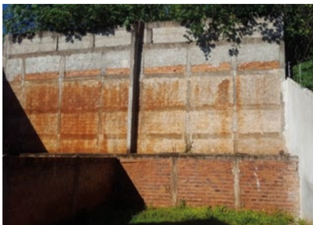
Figura 4. Muro de arrimo com infiltração
